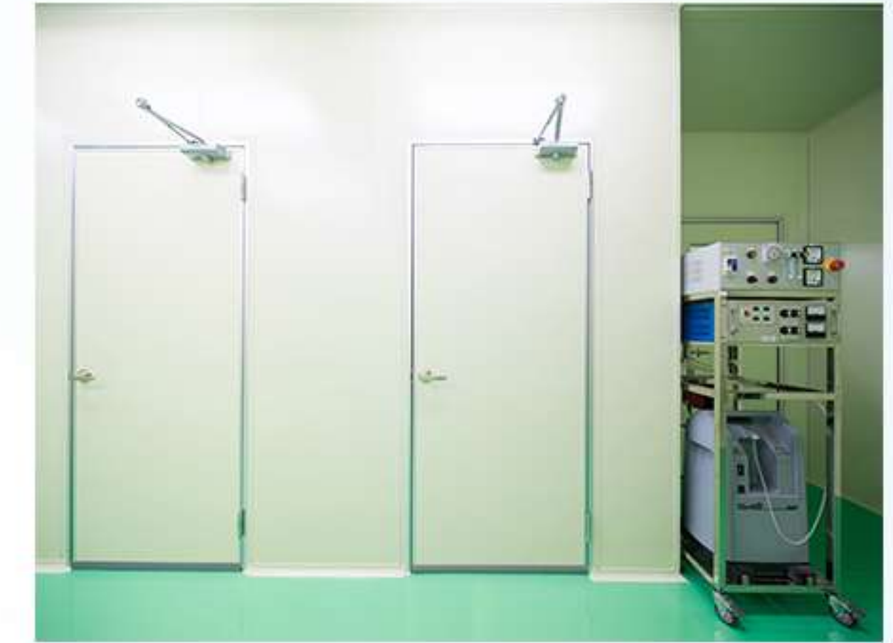
臭氧滅菌設備
